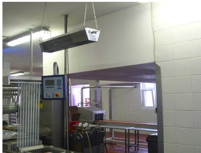
Inštalácia prístroja PT nad baličkou syrov.
