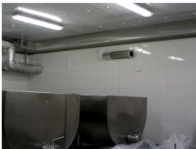
Inštalácia prístroja PT v priestore tvarohárne.
